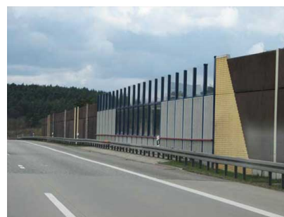
Fot. 19. Przykład zastosowania ekranu akustycznego na wiadukcie (Niemcy)
